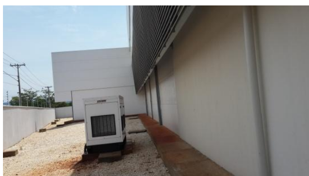
gerador próprio na central de urnas do TRE/TO
