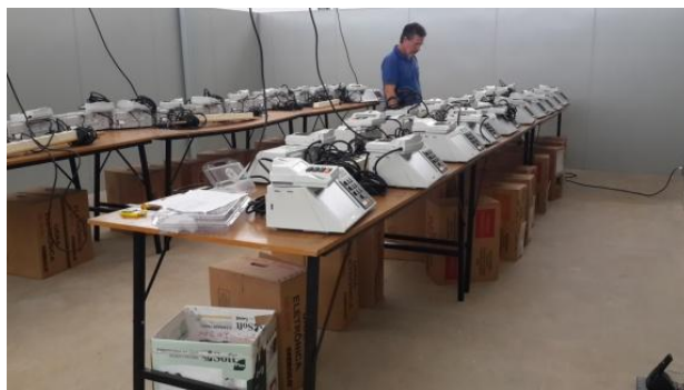
fiiação e tomadas em condições de suportar a energia na central de urnas do TRE/TO
